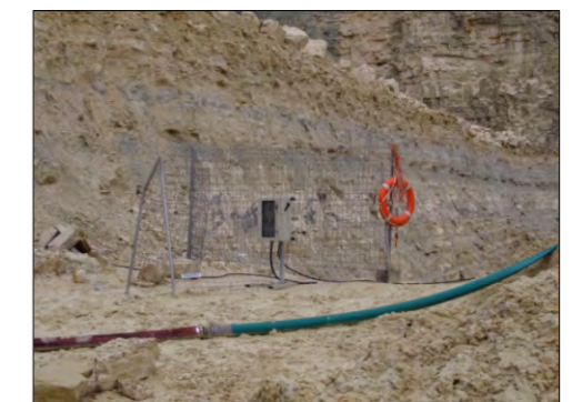
Grillage protecteur autour des transformateurs et bouée a proximité des bassins
